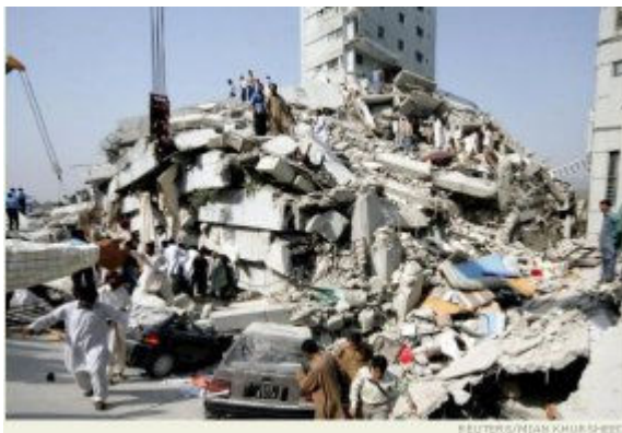
Au centre d'Islamabad un immeuble effondré
