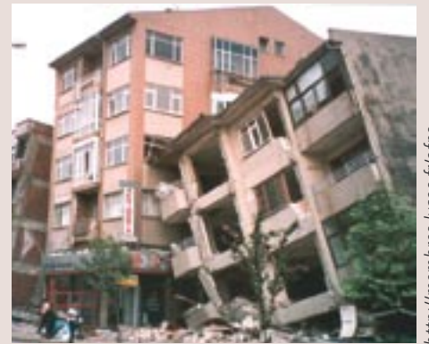
Perte de portance par liquéfaction du sol (séisme d'Izmit en Turquie).
